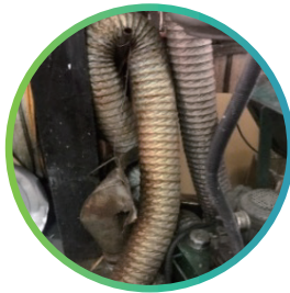
風管彎折嚴重 影響抽氣效果
